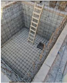
Cisterna de concreto armado de 3,000 litros
